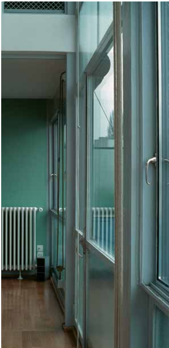
Restaurierte Schiebefenster, Immeuble Clarté, Genf 1931/1932 Le Corbusier
